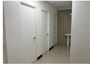
Baterías de baños
