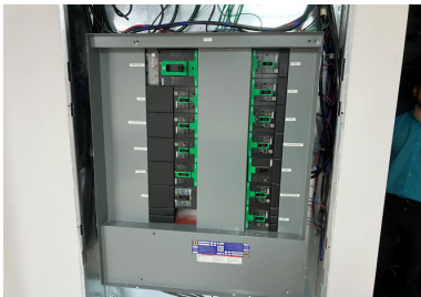
Caja de breakers
