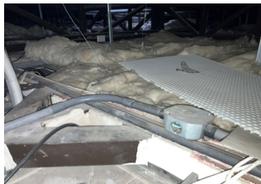
Detalle sistema eléctrico
